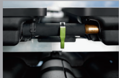
Solarschlauch und Federbandschellen beim Logasol SKN 4.0.
