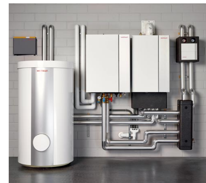
Hybridsystem Wärmepumpe mit Gasbrennwertgerät
